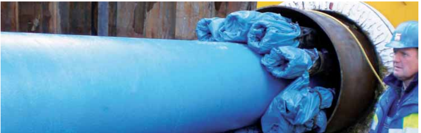
Kollektorleitung: Rheindüker Worms – DN 600
